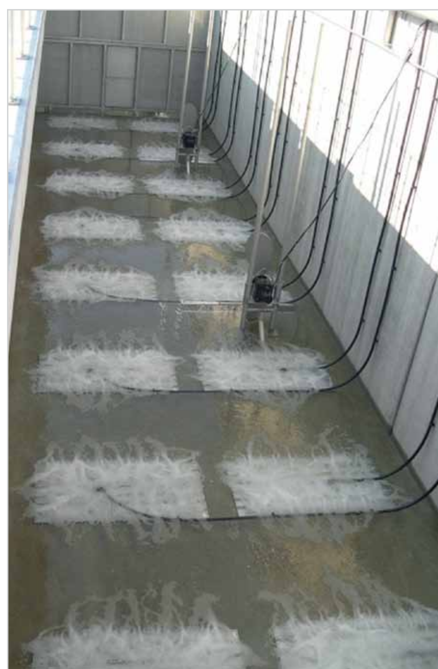
Belüfterplatten und Rührwerke (Becken entleert)
