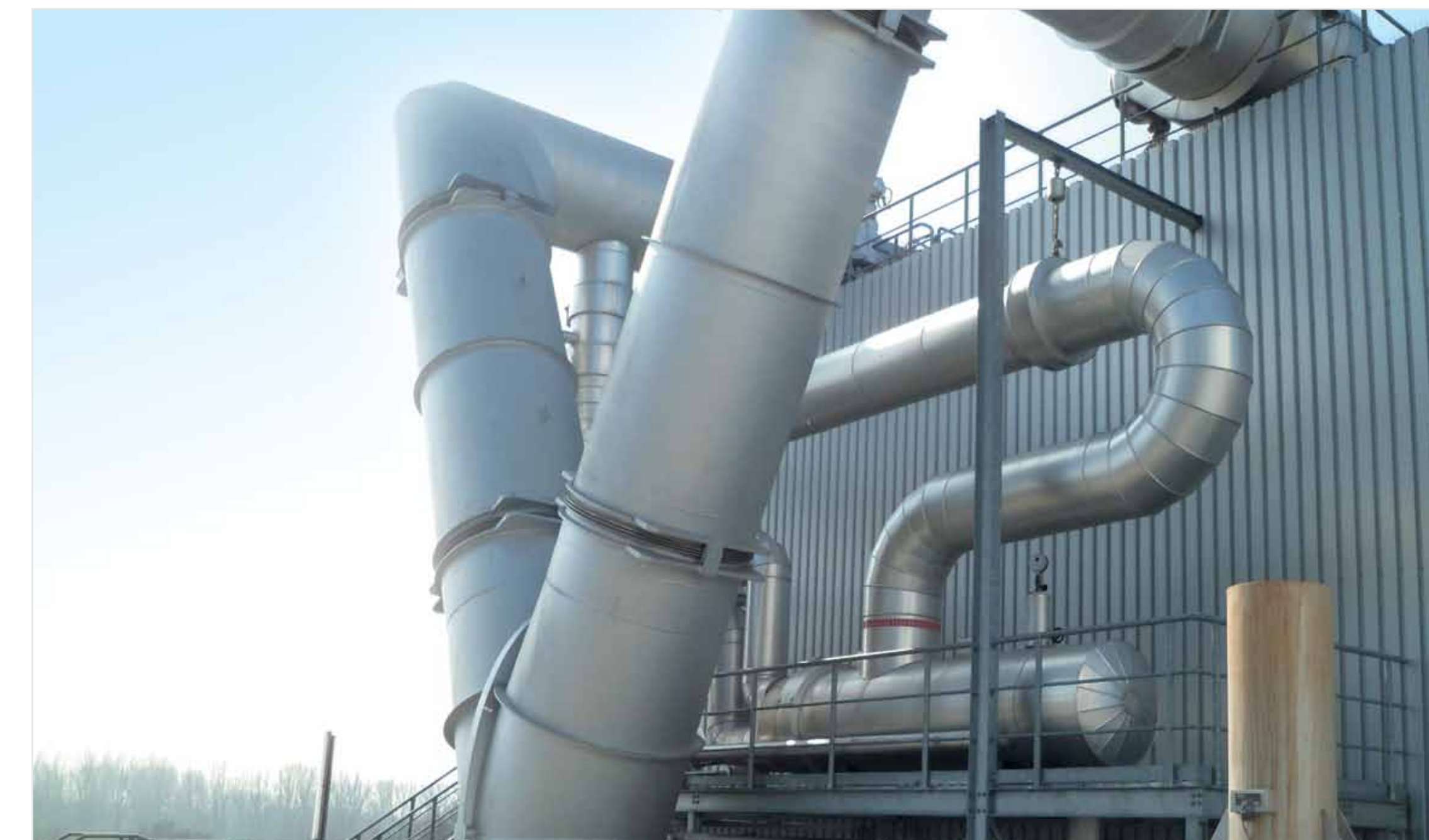
Wärmetauscher bei der MVA
