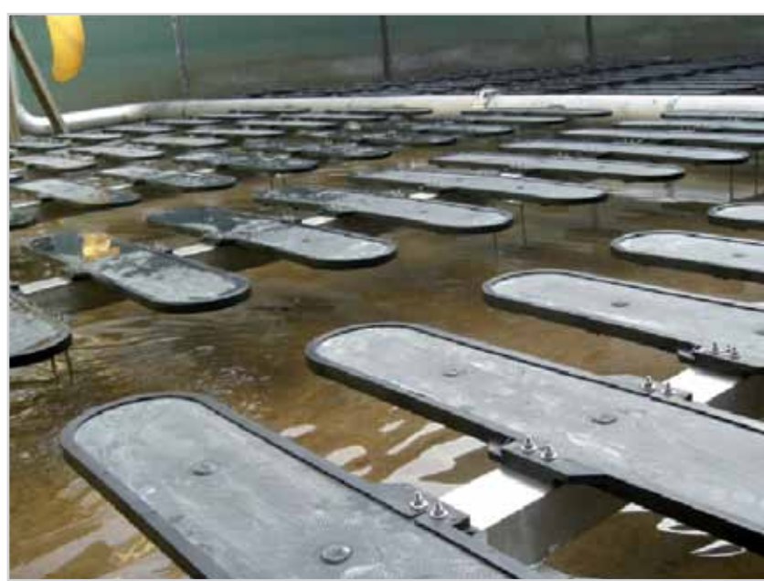
Plattenbelüfter in den SBR-Reaktoren
