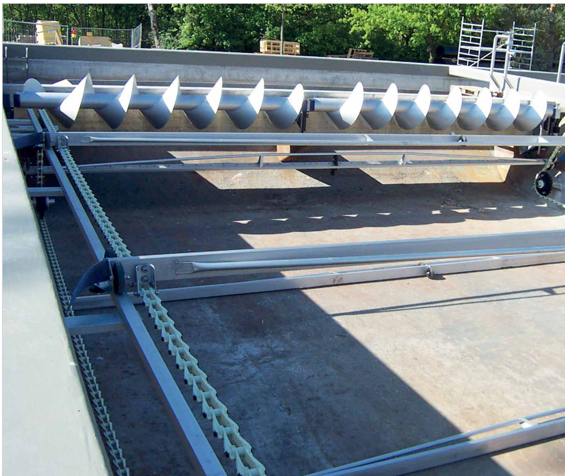
Kettenräumer und Schnecke für den Schwimmschlammabzug (Becken entleert)
