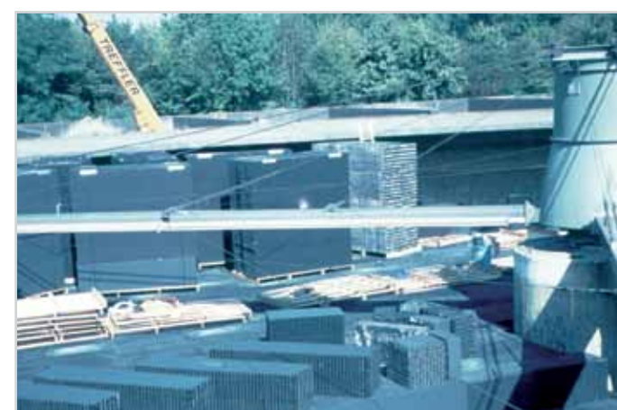
Wabenförmiges Kunststoffblockmaterial mit einer größeren Aufwuchsfläche im Tropfkörper 4
