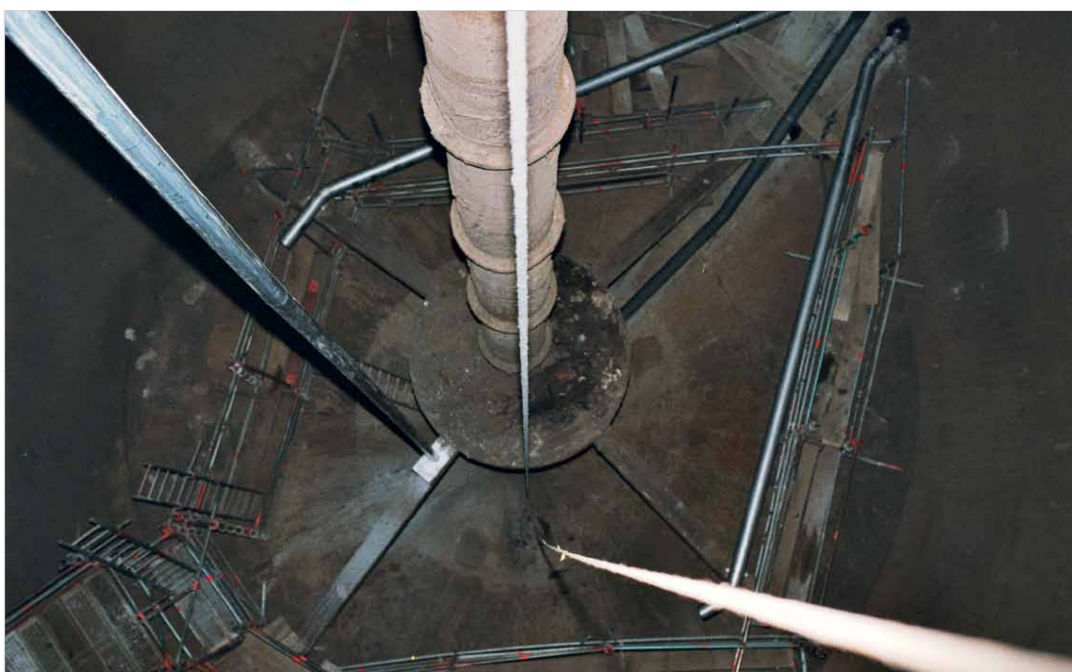
Mischer im Faulbehälter
