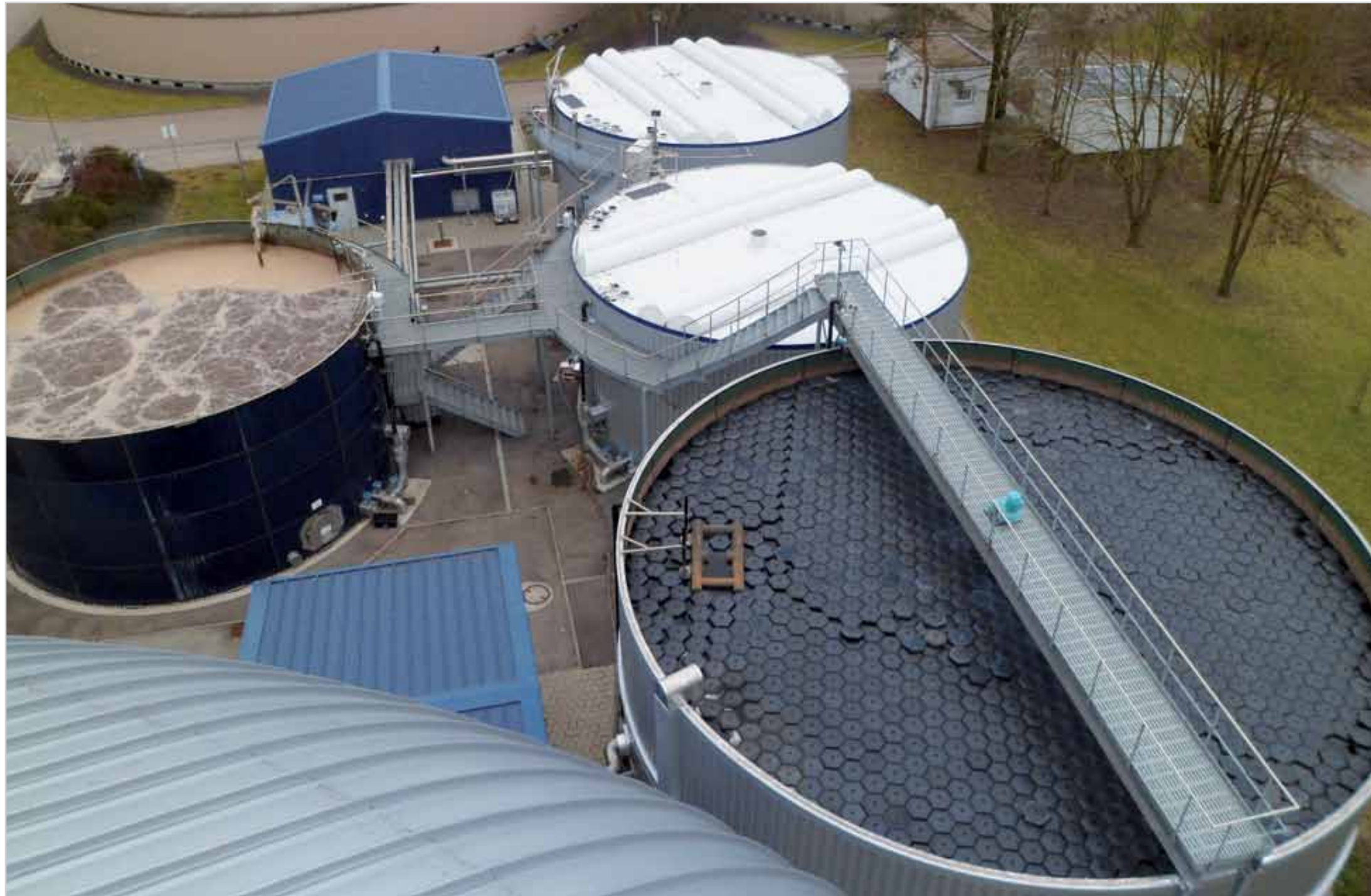
Speicherbecken und SBR-Reaktoren
