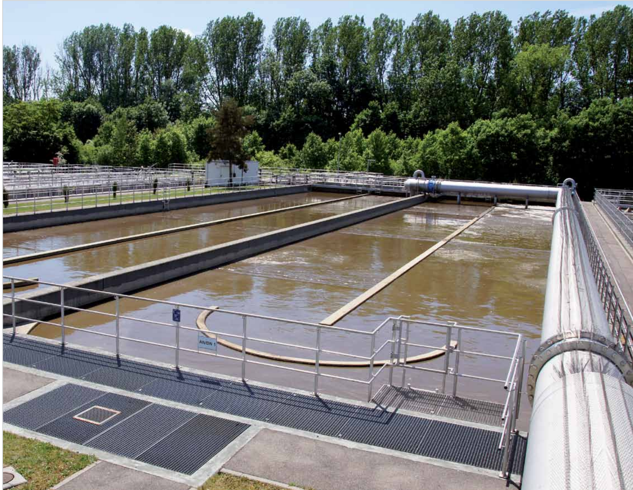
AN/DN Becken mit Rezi-Leitung
